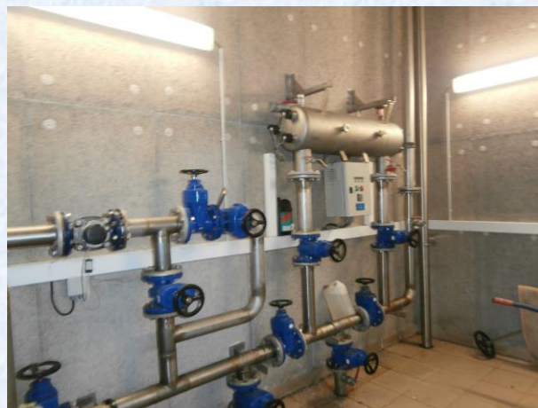
Traitement des eaux par UV
